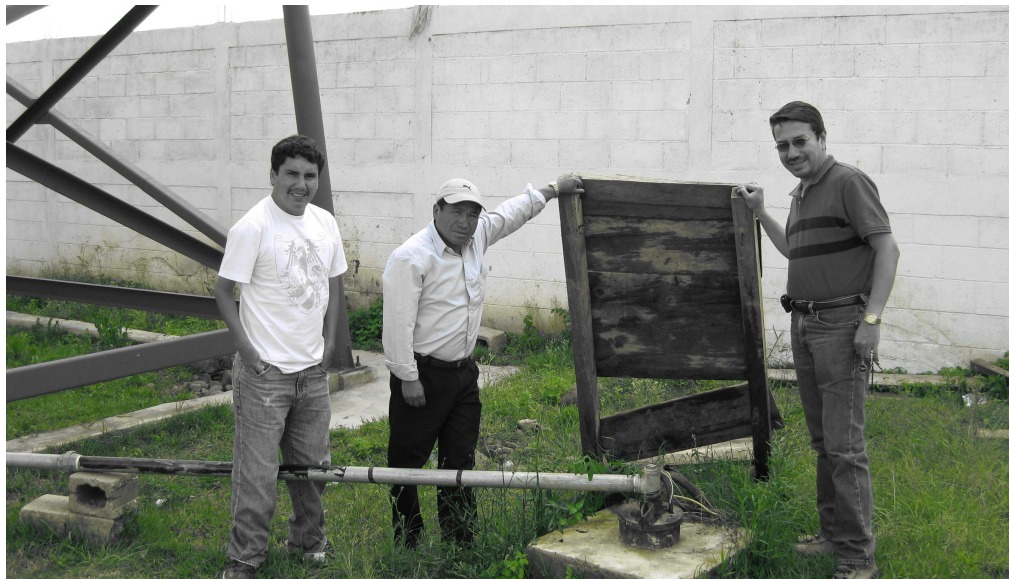
Boca del pozo que lleva el agua al depósito en el proyecto “Plan de saneamiento básico: suministro de agua potable a 2 aldeas del Quiché”, en Guatemala
